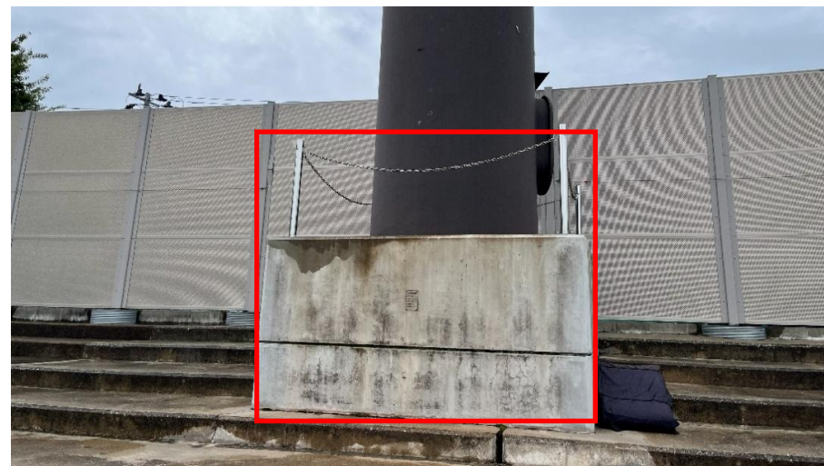
照明器具下部
