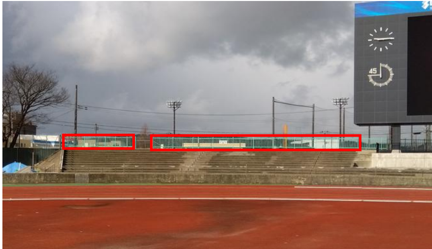
大型映像装置左側上部手すり(高さ約94cm)
